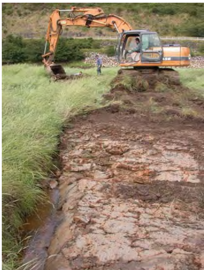
Photo 22 - Le bouchon argileux a été confectionné à partir d'argile prélevé sur un bord du fossé et selon un profil un pente douce de manière à obtenir une mare favorable au développement de ceintures de végétation aquatique.
